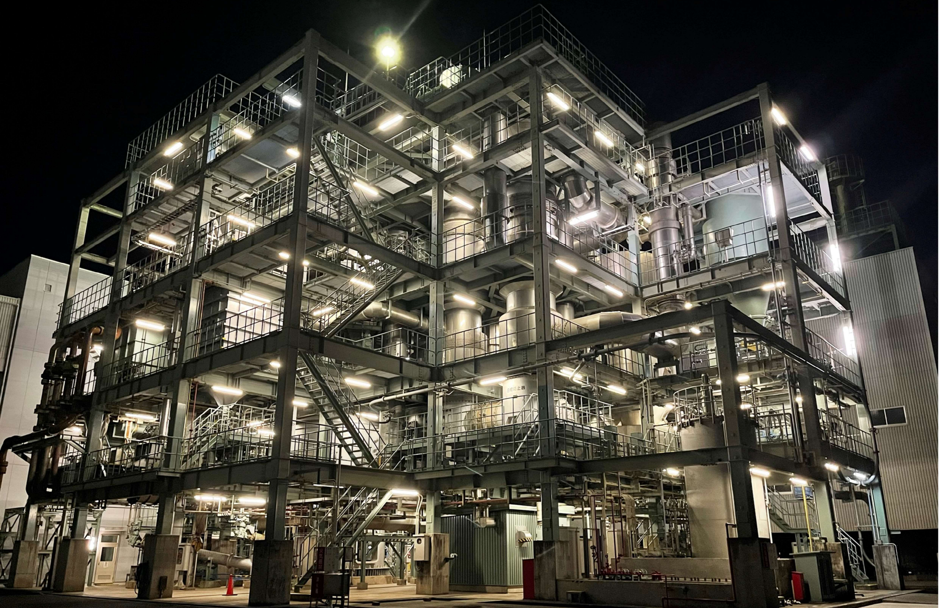
〈四之宮水再生センター焼却炉〉
